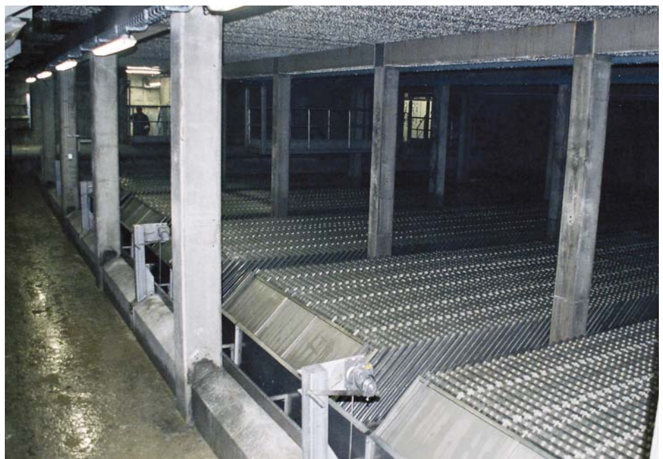
Intérieur du décanteur, lames en position inclinée
