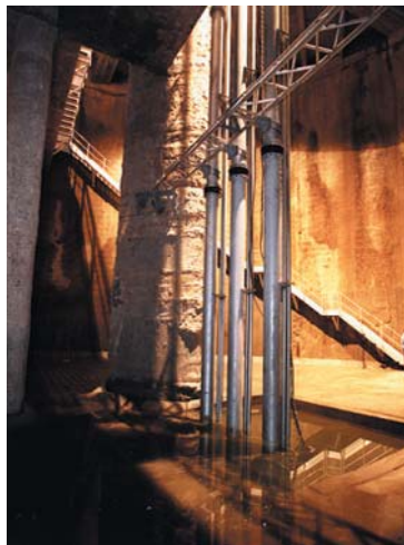
DUNKERQUE Vue de l'intérieur du bassin : systèmes de relevage et accès
