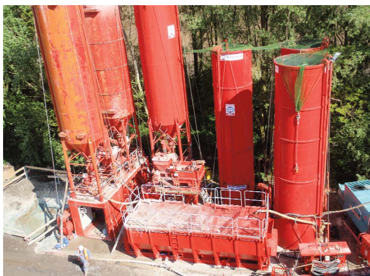
Centrale de fabrication de coulis et de boue bentonitique
