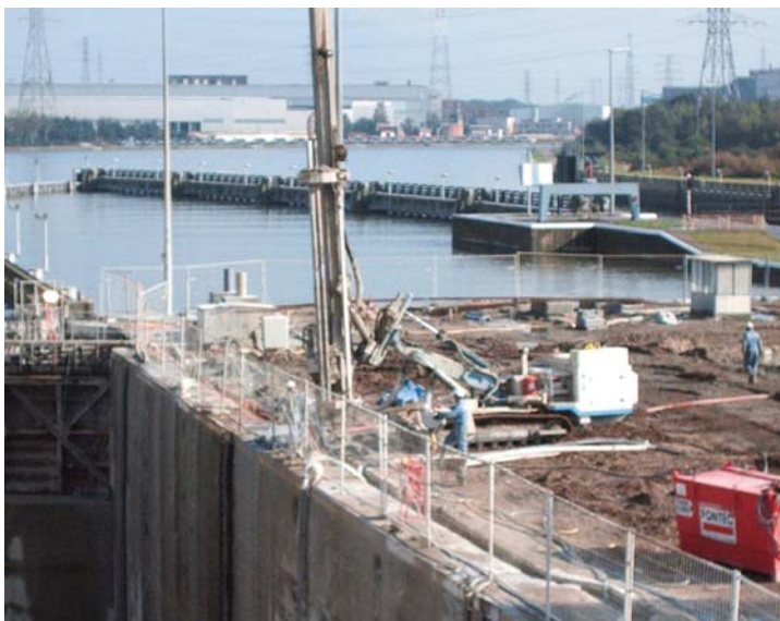
Tirants d'ancrage dans les bajoyers
