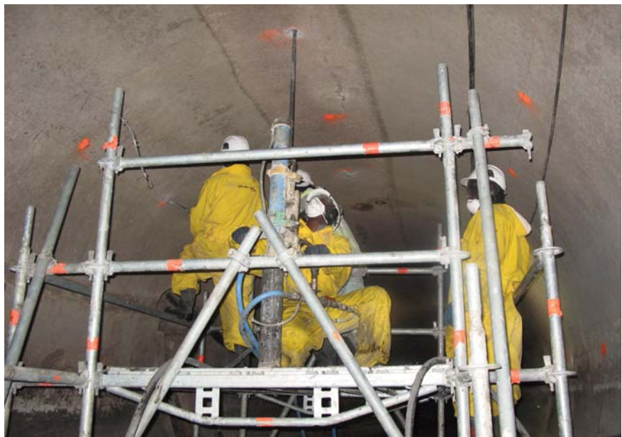
L'émissaire est un espace confiné, ce qui implique le port d'EPI supplémentaires, comme des détecteurs de gaz ou des casques protecteurs pour lutter contre les effets d'accentuation de bruit.
