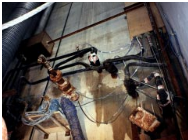
Rampe de distribution de l'azote liquide
