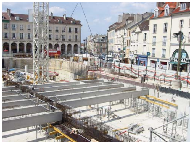
Mise en place des poutres pour la réalisation de la dalle de couverture
