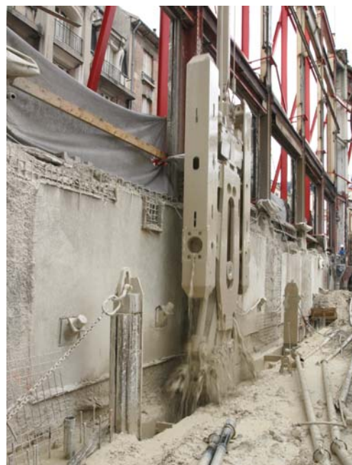
La paroi moulée a été excavée > au ras des façades par des bennes KS 3-2
