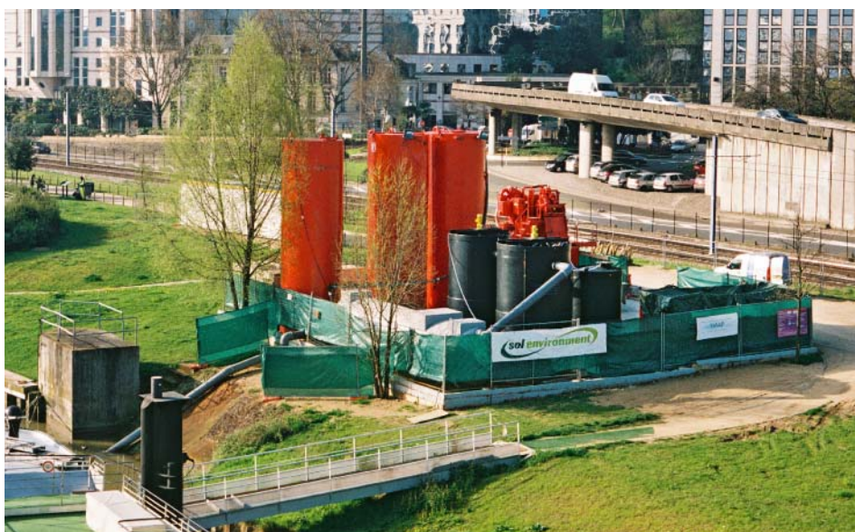
Station de traitement provisoire
