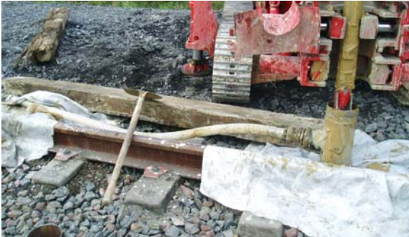
Protection du ballast des voies et tube d'aspiration de rejets
