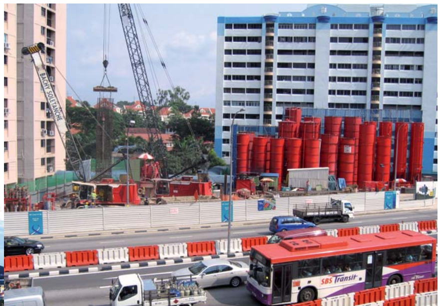
Vue d'ensemble de la centrale de bentonite et de la construction des murs de soutènement pour l'entrée d'une station
