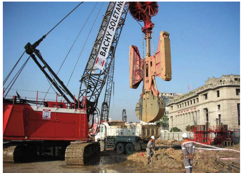
La benne preneuse à ouverture de 5 mètres conçue spécialement pour le projet
